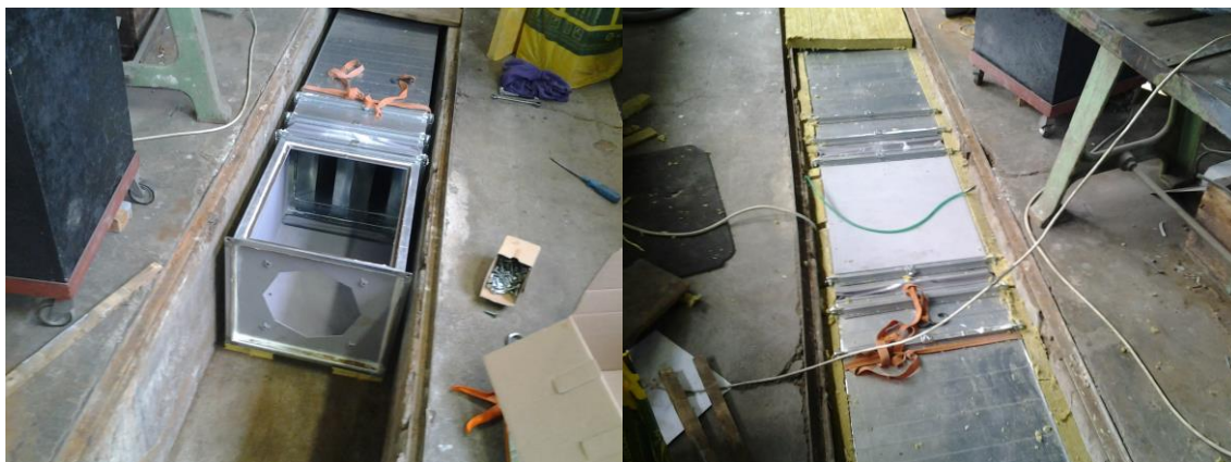
Obr. 5-13 Fotografie uložení ventilátorové skříň a potrubí v sousední místnosti.
