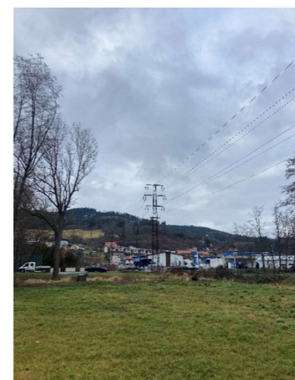
Obr. 98 - Nadzemní vedení vysokého napětí
