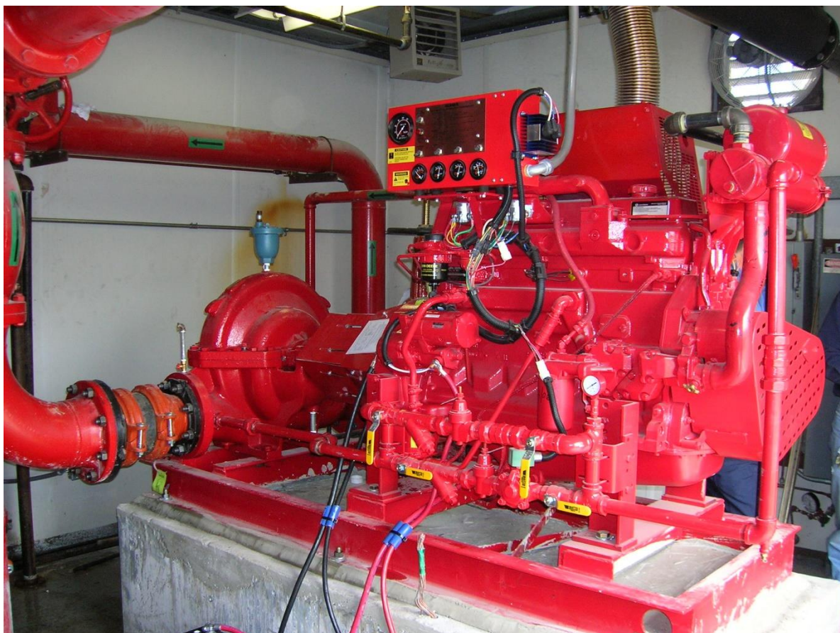
obr. 12 Požární čerpadlo s diesel motorem [11]
