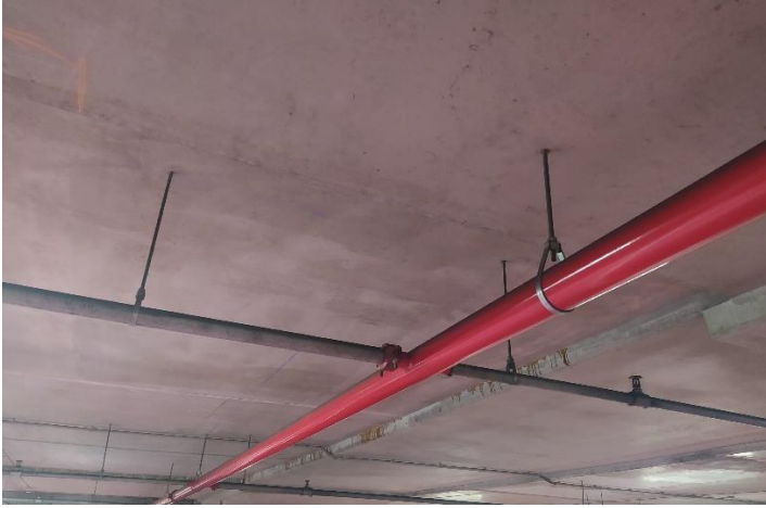
obr. 16 Závěsy sprinklerového potrubí (vlastní foto)
