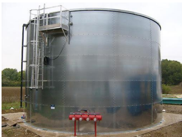
obr. 8 Nadzemní požární nádrž [8]
