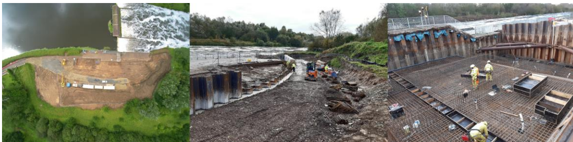
Obrázek 9 HANUS, D., postup výstavby, vlevo-příprava staveniště, uprostřed-nová linie Larsen a železobetonový věnec, vpravo stavební jáma a armování základové desky [fotografie]
