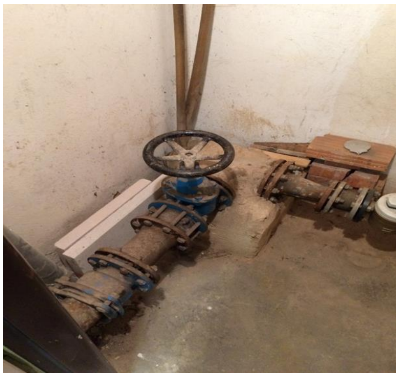
Obr.22. - Hlavní uzávěr vody
