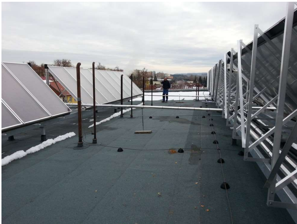
Obr. 24: Kolektorové pole na střeše objektu kotelny [6]
