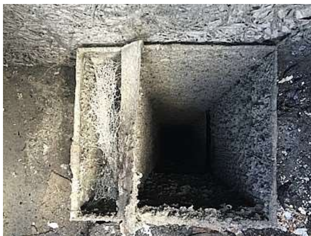
Obr. 19: Znečištěné VZT potrubí [41]
