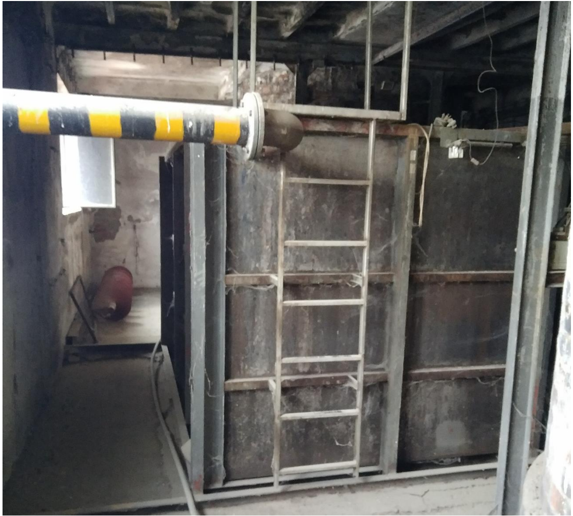
Obrázek 22 – Akumulační nádrž na vodu pro výrobní proces nad máčírnu. Zdroj: vlastní foto
