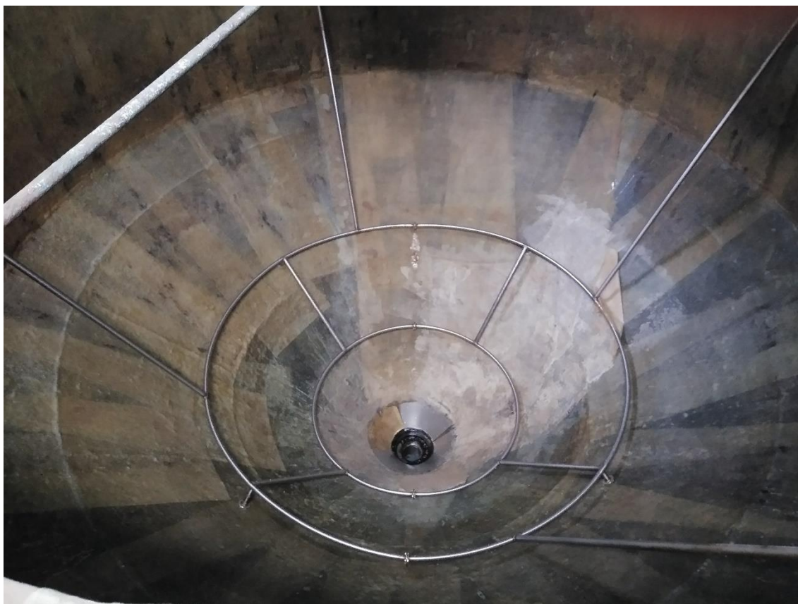
Obrázek 20 – Pohled na prázdný náduvník s trubními rozvody tlakového vzduchu na provzdušňování. Zdroj: vlastní foto
