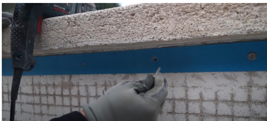
Obr. č. 23 – instalace ocelového pruhu s fólií nýty na horní okraj vany (18)
