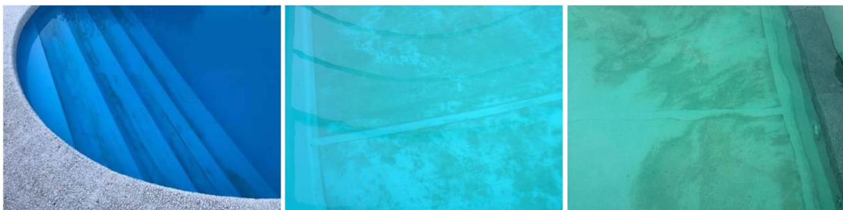
Obr. č. 36 – Skvrny způsobené sloučeninami kovů na povrchu fólie (24)
