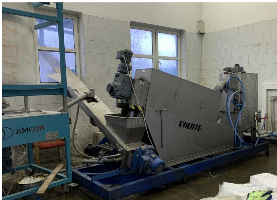
Obr. 17 Zařízení na odvodňování kalu na ČOV Rudná
