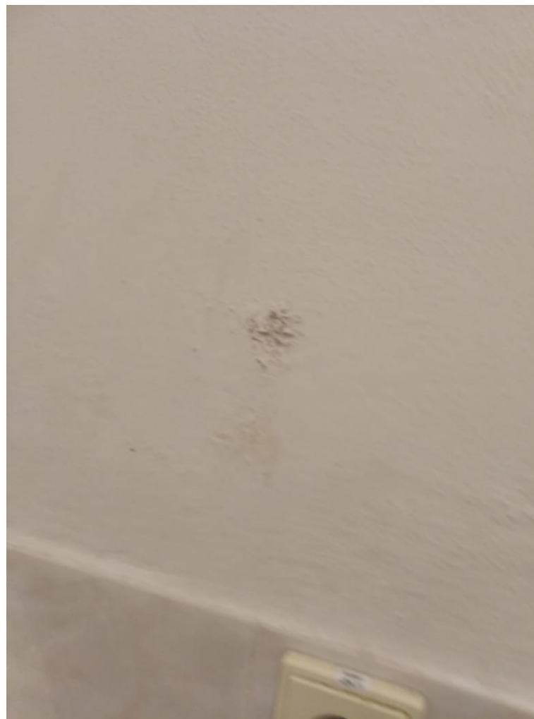
Foto 26 – poškození vnitřních stěn
