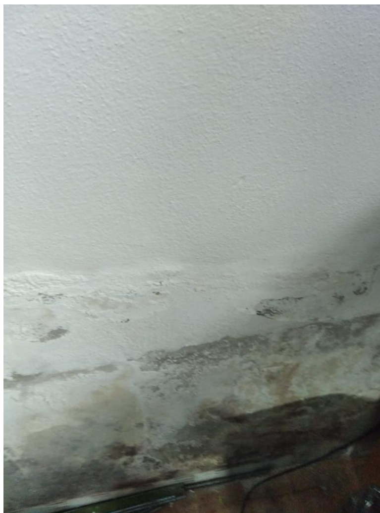
Foto 24 – poškození vnitřních stěn
