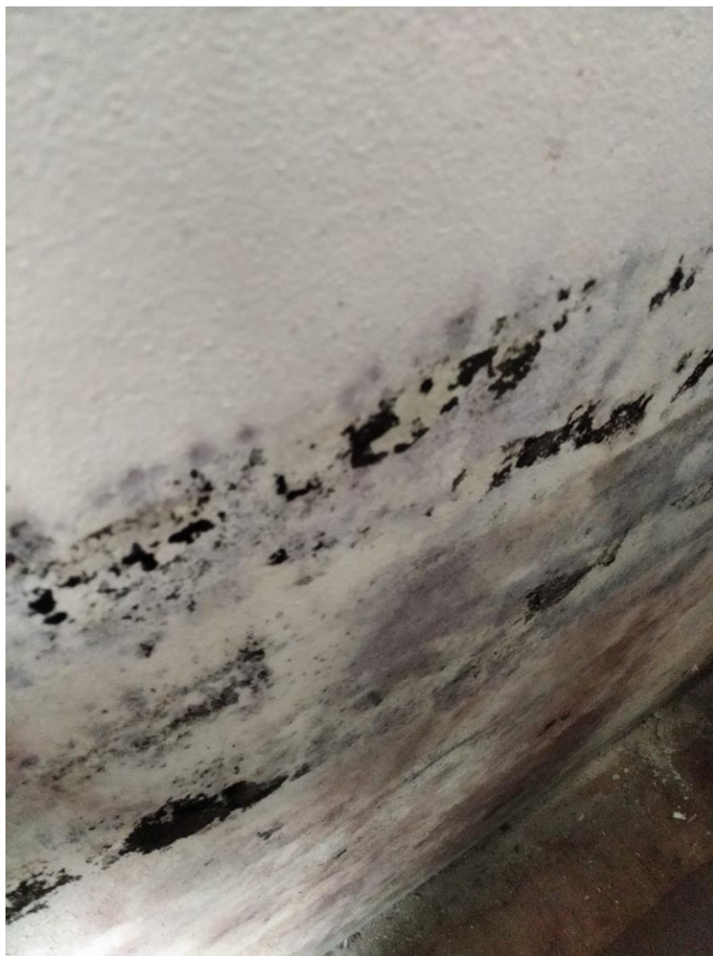
Foto 21 – poškození vnitřních stěn
