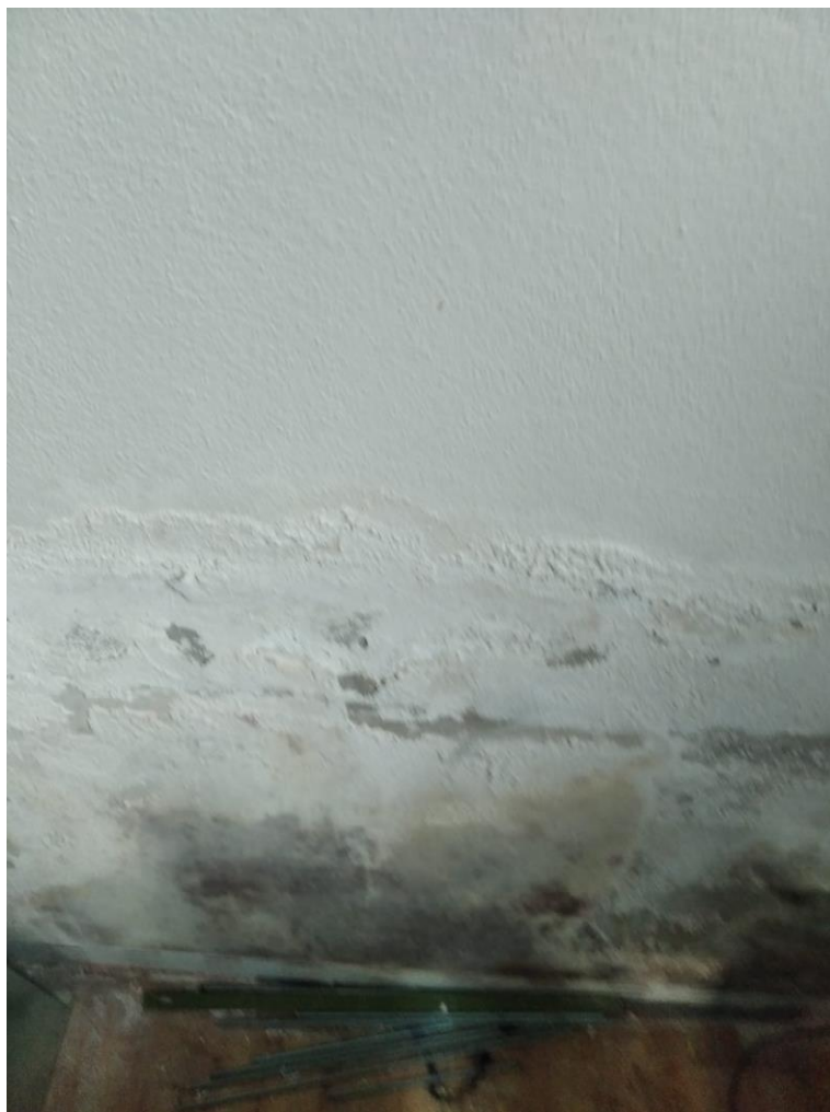
Foto 25 – poškození vnitřních stěn
