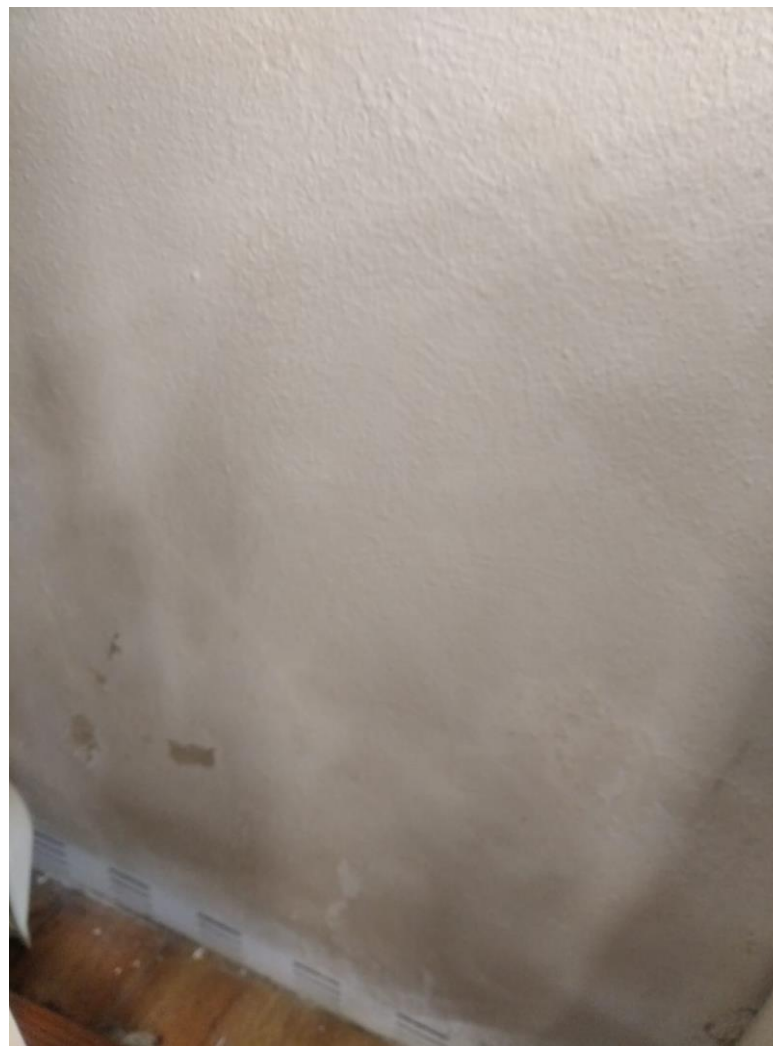
Foto 22 – poškození vnitřních stěn
