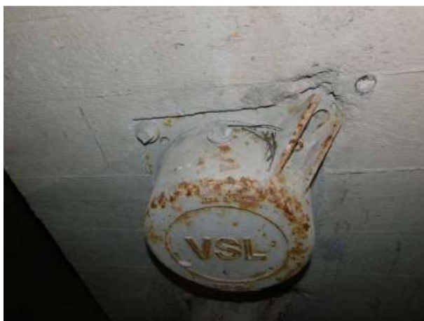
Obrázek 125 koroze krytů kotev
