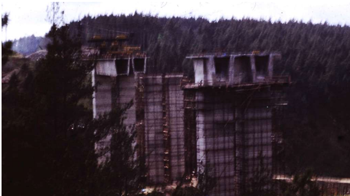
Obrázek 10 zárodky na pilířích
