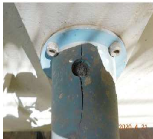
Obrázek 124 prasklina závěru uzávěru krytu kotvy
