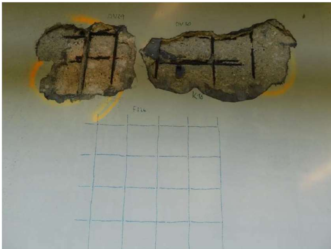
Obrázek 118 odpadlá krycí vrstva
