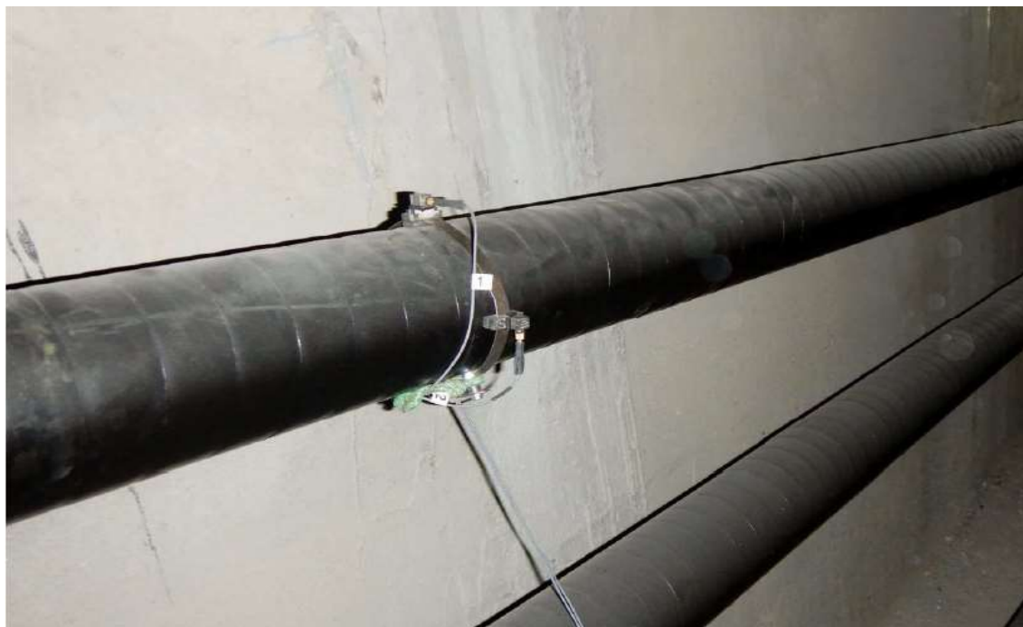
Obrázek 123 detail kabelu se snímačem zrychlení
