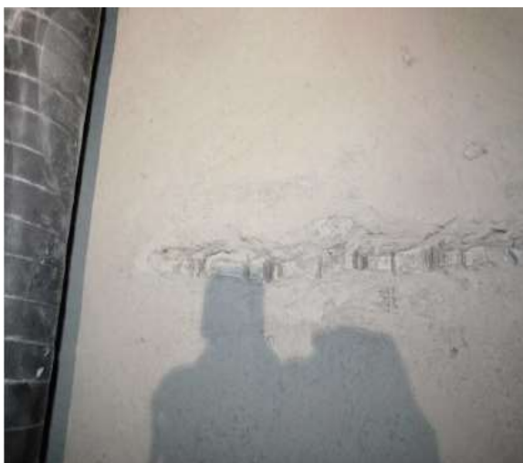
Obrázek 121 obnažená výztuž bez koroze
