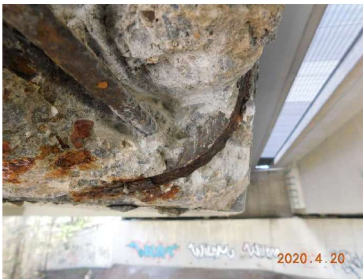
Obrázek 119 zkorodovaná odhalená výztuž
