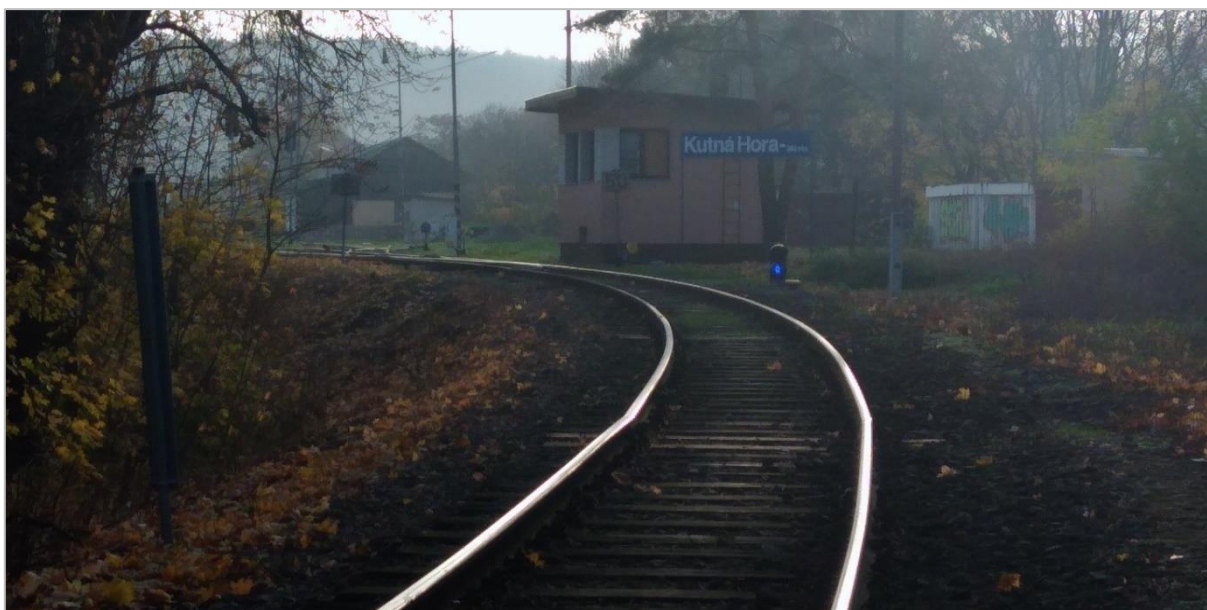
Obrázek 3: Zřetelně viditelný nevyhovující stav styku; vlastní fotodokumentace (08.11.2018)
