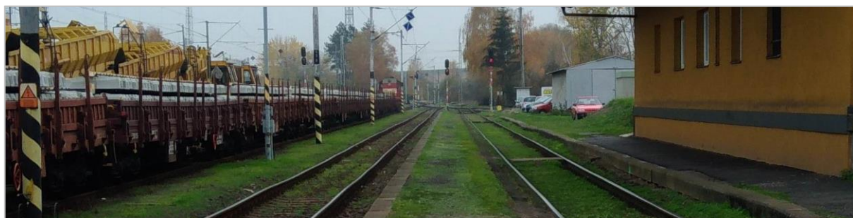
Obrázek 2: Zvlněné koleje patrné i z výšky očí (Kutná Hora hl.n., koleje 11 a 13); vlastní fotodokumentace (08.11.2018)
