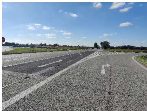
Obrázek 26: Nevyhovující stav povrchu s vyšším smykovým třením
