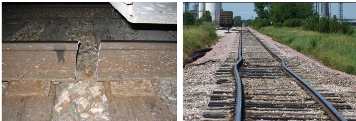
Obr. 1.2: Poruchy bezstykové koleje (vlevo: lom kolejnice; vpravo: vybočení koleje) [1]
