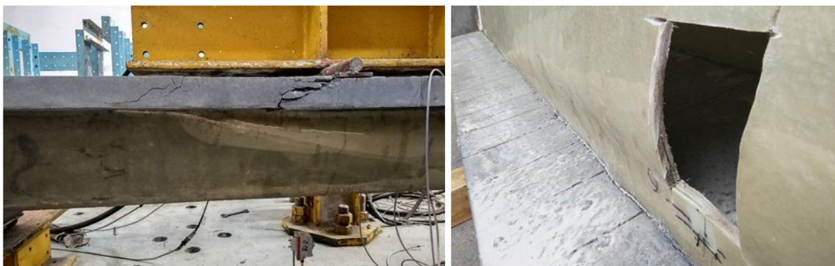
Obr. 73 Smykové trhliny v betonové desce, Inspekční otvor – viditelná delaminace stojiny
