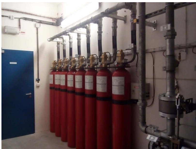
obr. 2: Osazené tlakové láhve s hasicím plynem (archiv autora)
