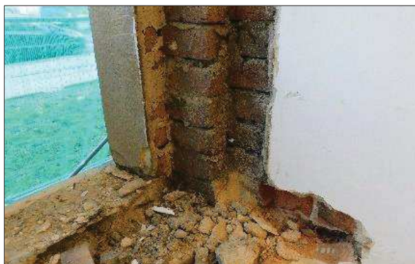
Obr. 4: Obnažené ostění původního dvojitého okna
