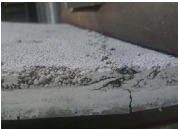
Obr. 89 Nerovnoměrné rozmístění složek betonu v desce z horizontálního bednění (59)
