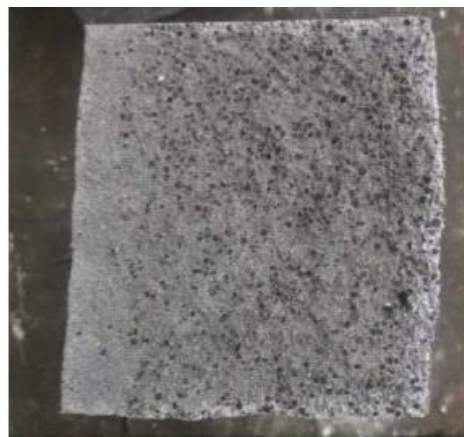
Obr. 90 Nerovnoměrné rozmístění složek betonu v trámci (59)
