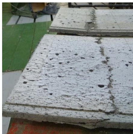
Obr. 70 Průběh trhlin v deskách (66)
