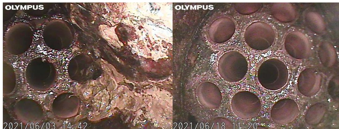
Obrázek 32 – Stav povrchu před a po vyčištění – primární okruh
