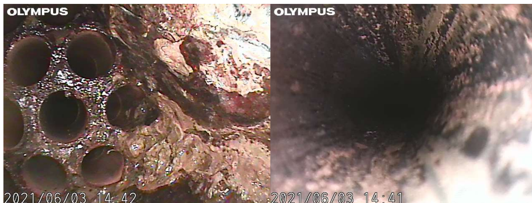
Obrázek 20 – Zanesený vnitřní povrch primárního okruhu před vyčištěním
