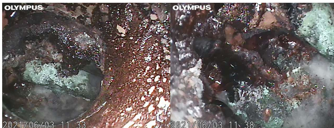
Obrázek 21 – Zanesený vnitřní povrch sekundárního okruhu před vyčištěním
