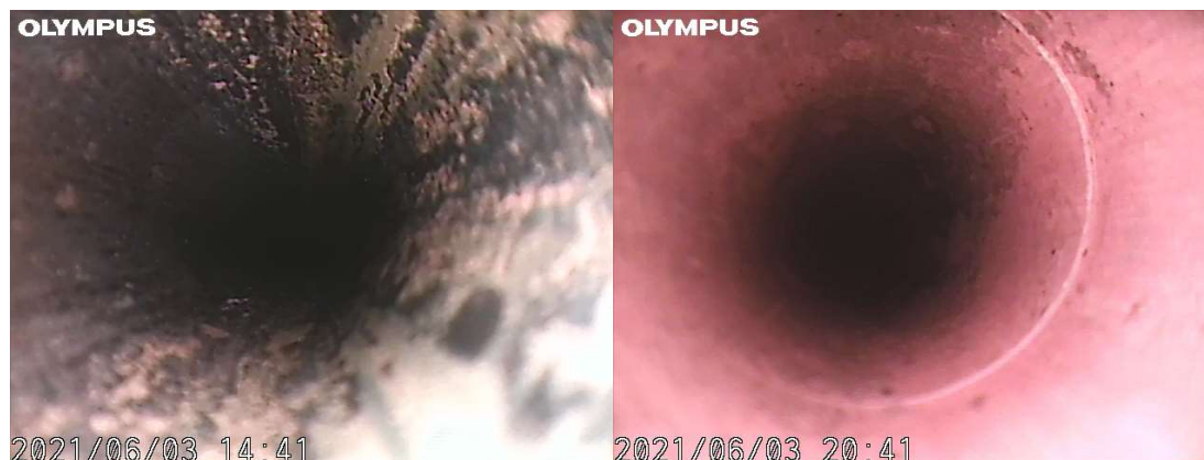
Obrázek 33 – Stav povrchu před a po vyčištění – primární okruh
