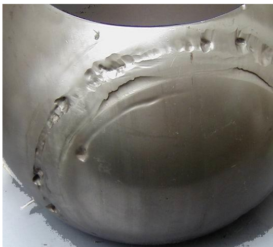
Obrázek 21: Erozi poškozená koule uzávěru [24]
