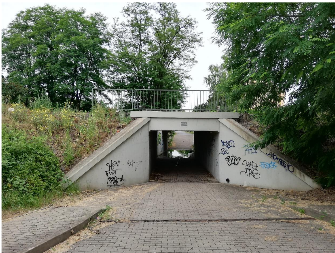
Obrázek 54 – Stávající železniční most v žst. Neratovice, v jehož poloze bude vybudován nový, který bude vyhovovat automobilové i pěší dopravě
