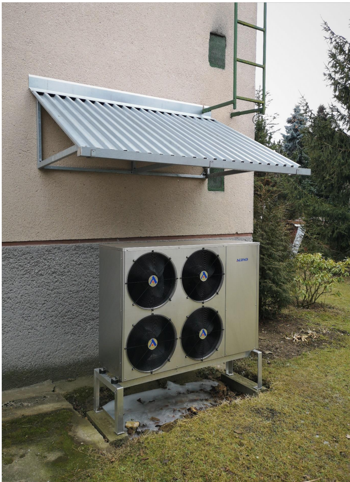
Obr. 38: Instalované tepelné čerpadlo ACOND TČ 17 EVI-S
