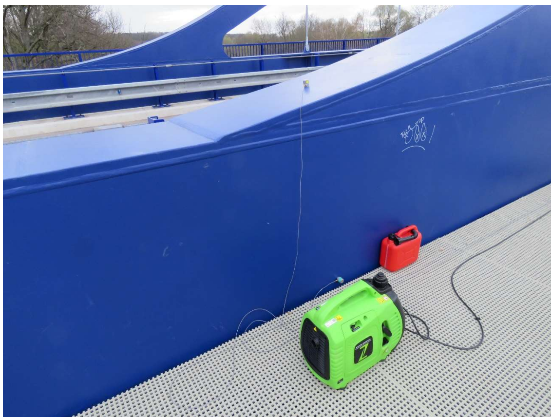
Obrázek 34: Umístění elektrocentrály na pilíři P4.
