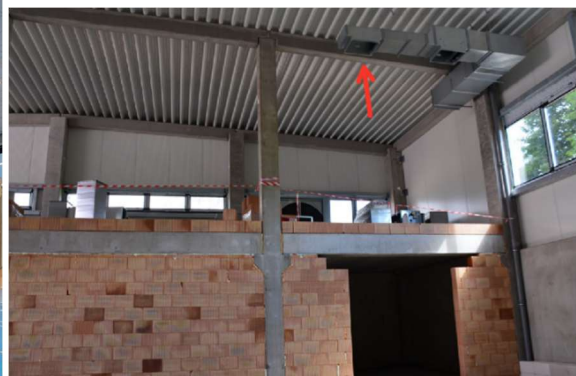
4.5 - Odvodní mřížka vzduchu sportovní haly [18]
