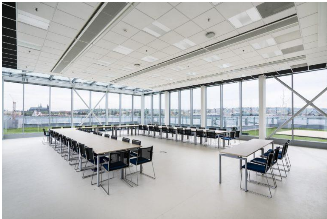
Obr. č. 13 Indukční jednotky v budově CIIRC 22
