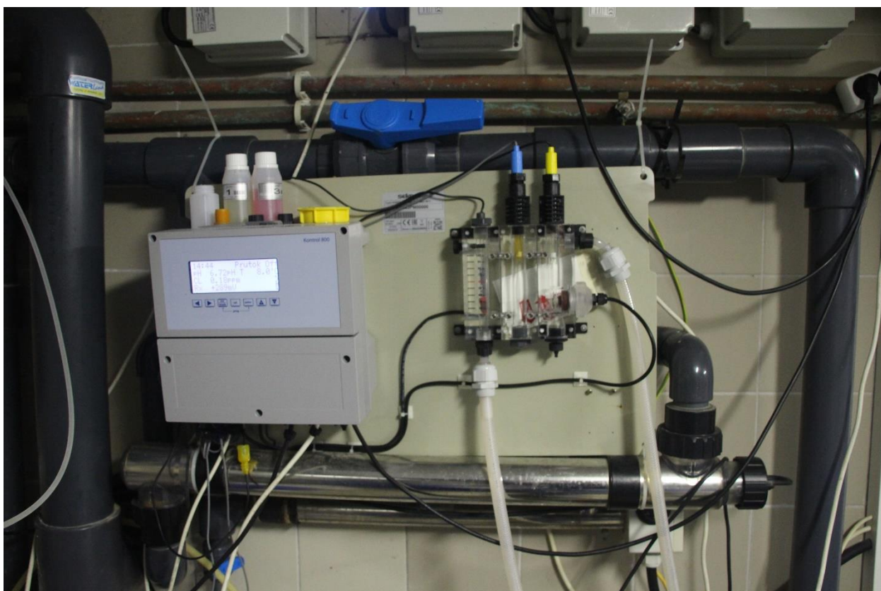
Obr. 13 : Detailní pohled na měření a regulaci na bazénu ve společnosti Vágnerpool.
