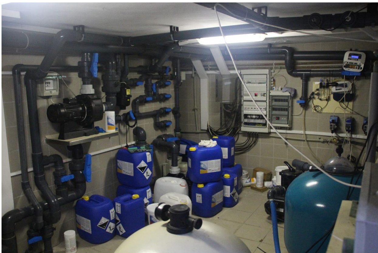
Obr. 11 : Pohled na recirkulační úpravnu bazénu při měření rychlostí na bazénu ve společnosti Vágnerpool.
