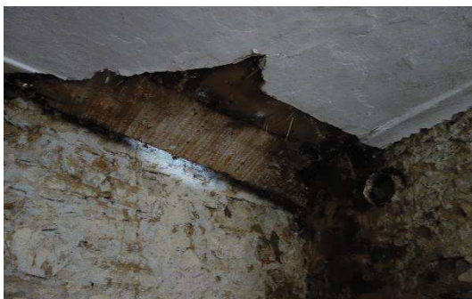
Obr. 85 Porušené podbití vlhkostí
