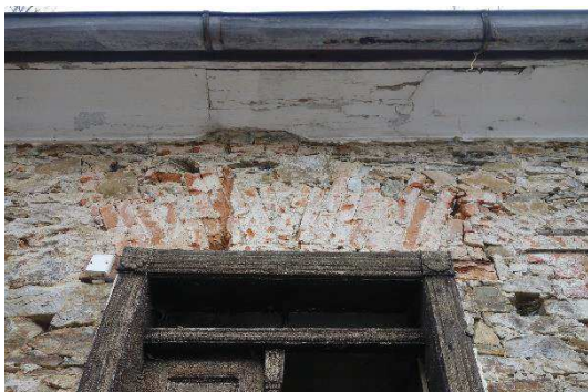
Obr. 87 Porušený profil mezi stěnou a krovem
