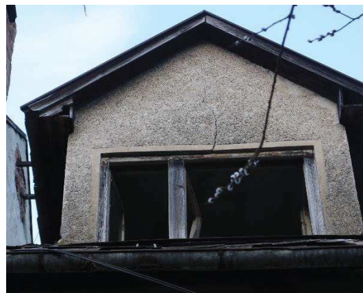
Obr. 62 Trhlinka nad oknem
