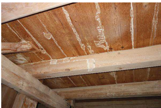
Obr. 44 Solné mapy na konstrukci stropu
