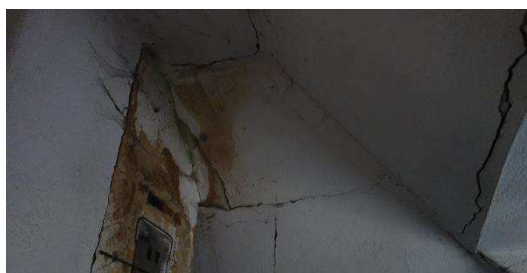
Obr. 74 Trhliny v krovu
