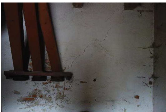
Obr. 40 Trhlina v místě uložení trámu
