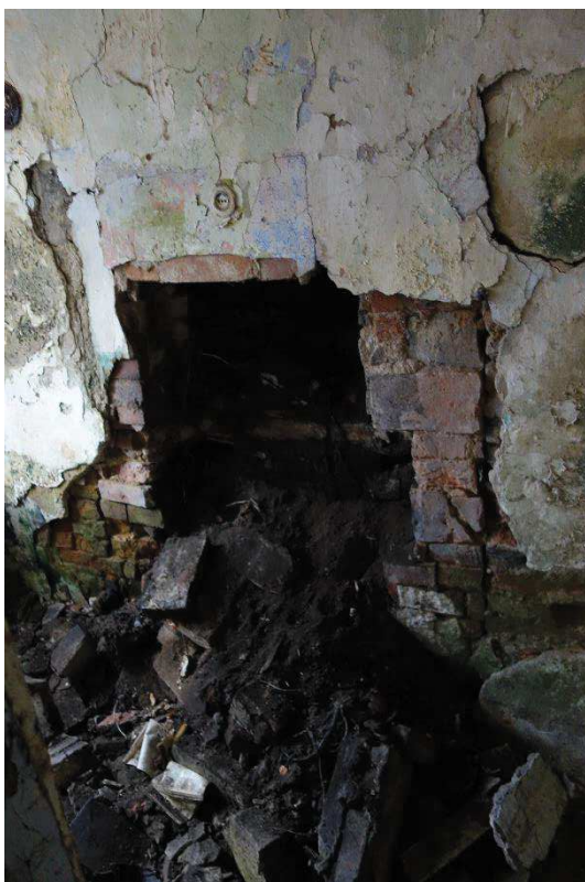
Obr. 58 Provalený komín v přízemí
