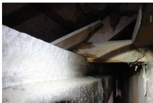
Obr. 47 Zatékání v oblasti pozednice
