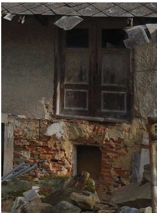
Obr. 38 Narušené cihelné zdivo
