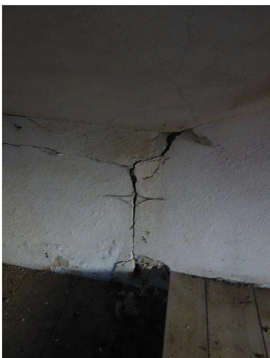
Obr. 69 Trhlina od pozednice
