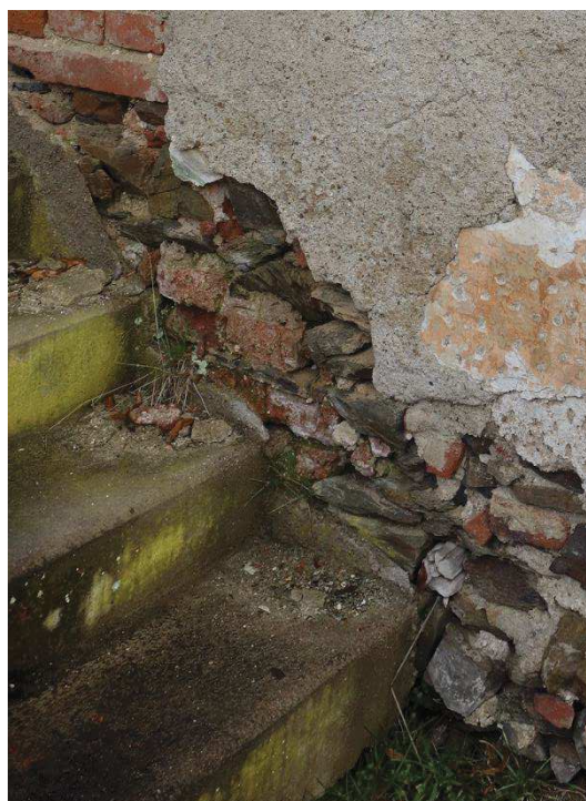
Obr. 39 Růst vegetace na konstrukcích
