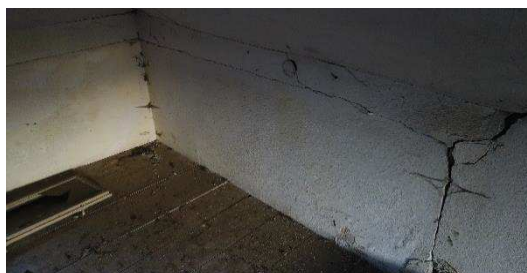
Obr. 75 Trhliny v krovu
