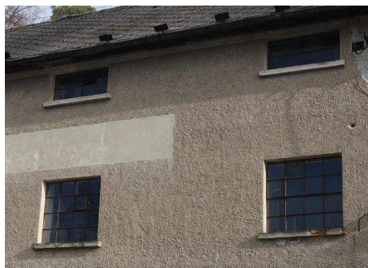
Obr. 56 Poškozené parapetní římsy
