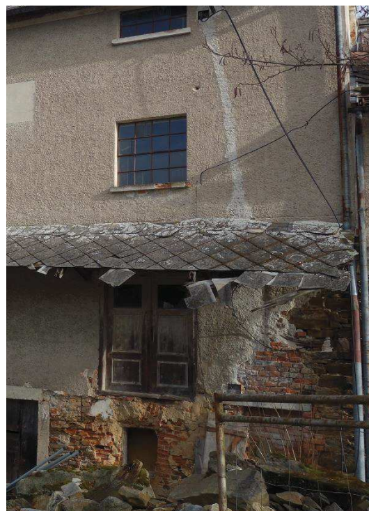
Obr. 36 Narušení obvodového zdiva
