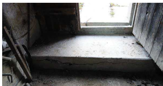
Obr. 57 Vodorovná trhlina ve schodu
