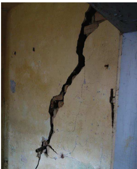
Obr. 64 Trhlina v příčce
