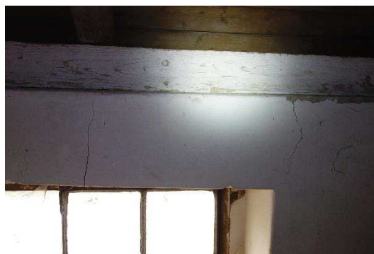
Obr. 41 Trhlina v nadpraží a v rohu otvoru
