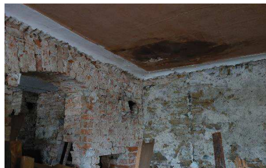
Obr. 86 Vlhké mapy od zatékání
