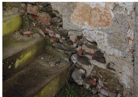
Obr. 33 Mech a tráva na konstrukci schodiště a přiléhajíc zdi
