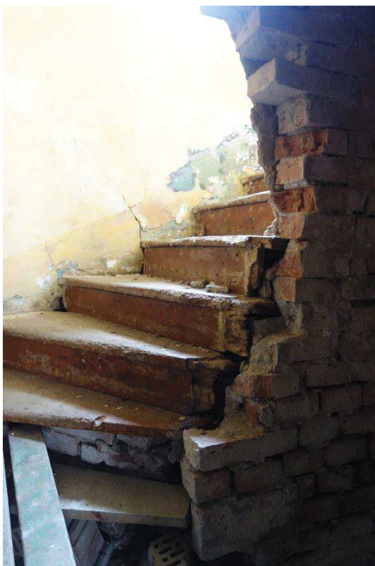
Obr. 67 Porušená schodišťová stěna
