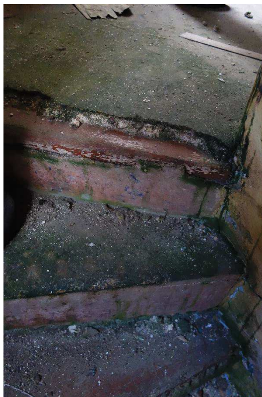
Obr. 78 Schodiště porostlé mechem
