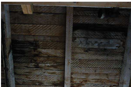
Obr. 48 Zatékání poškozenou střešní krytinou
