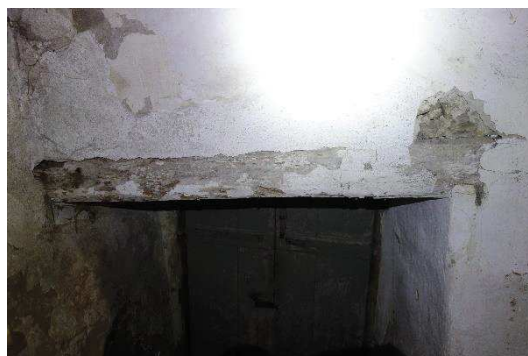
Obr. 45 Namáhaný dřevěný překlad
