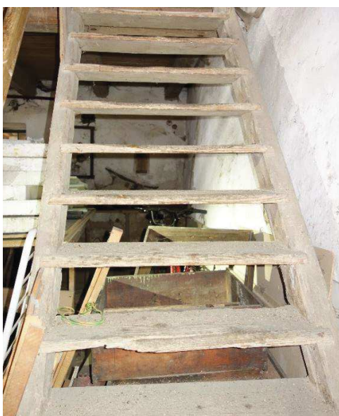
Obr.51 Mechanicky poškozené schodiště
