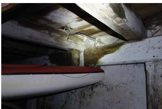
Obr. 42 Vlhká konstrukce stropu
