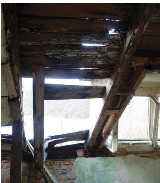
Obr. 73 Chybějící střešní krytina
