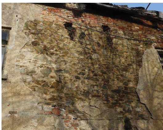
Obr. 61 Opadaná omítka a náletové rostliny na fasádě
