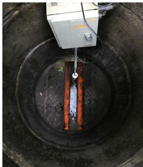
Obr. 46: Pohled do šachty se senzorem
