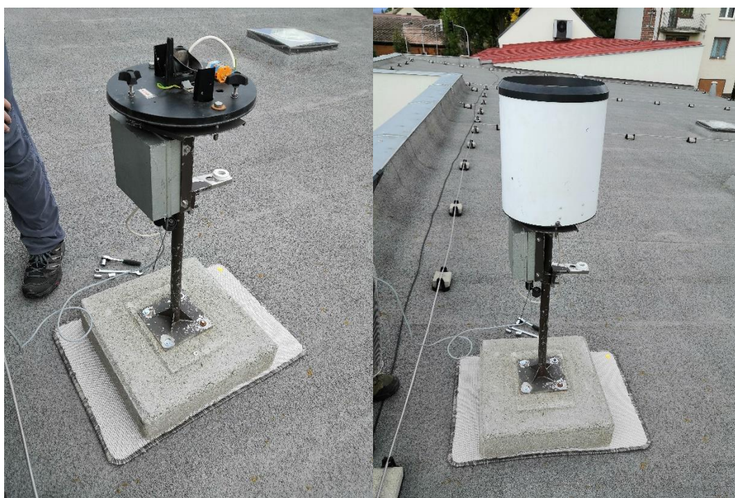
Obr. 47: Pohled na instalovaný srážkoměr bez ustalovacího válce (vlevo) a s válcem (vpravo)
