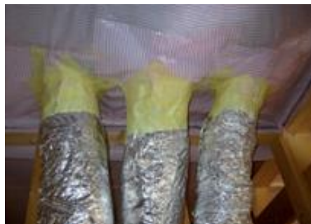
Obr.13b: nevhodně utěsněné prostupy nedostatkem prostoru [1]
