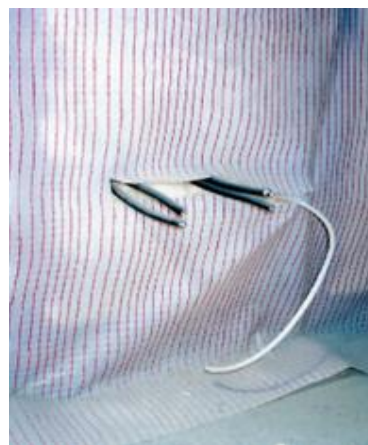
Obr.14b: nadměrné poškození vzduchotěsné vrstvy kabely [1]
