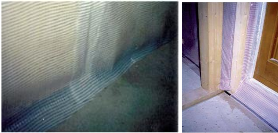
Obr.11a: chybné napojení parozábrany na podlahu [1]
