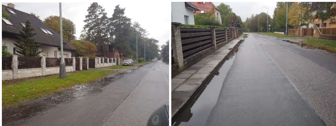
Obr. 14: Kumulace povrchového odtoku na rozhraní komunikace a zeleného pásu/chodníku (úsek ulice Šlechtitelské mezi napojením na ulici Slavětínskou a křížení s ulicemi Přímské náměstí a V Koutku) [65]
