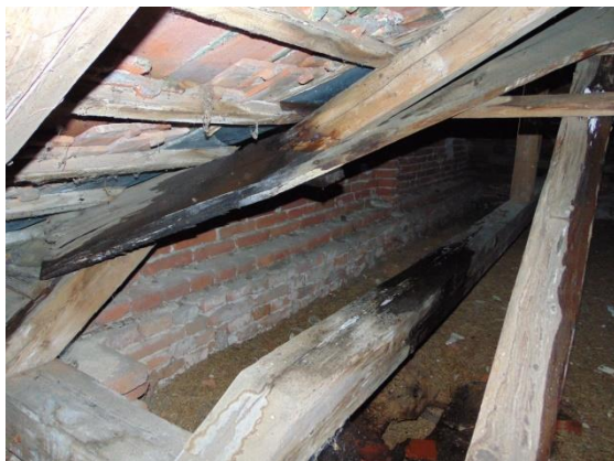
Obr. 47 Dřevěné prvky porušené hnilobou
