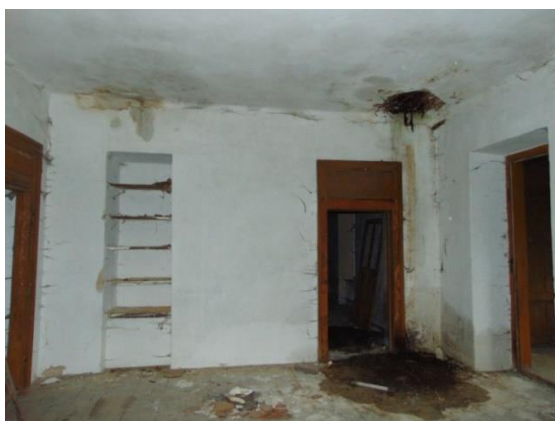
Obr. 41 Hlavní místnost – zatékání střechy
