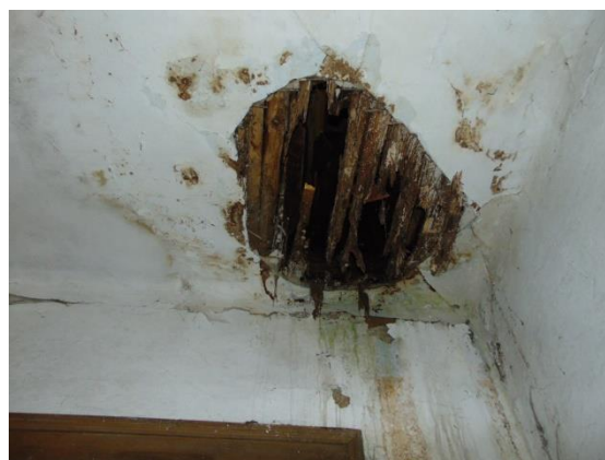
Obr. 42 Detail uhnílého stropu
