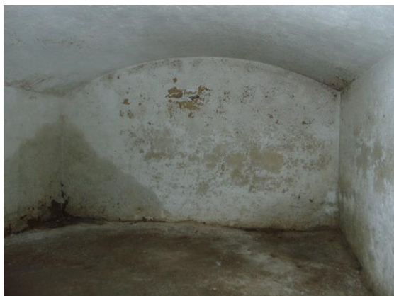
Obr. 39 Vztlínající vlhkost ve sklepích
