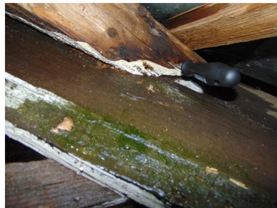
Obr. 48 Dřevěné prvky porušené hnilobou
