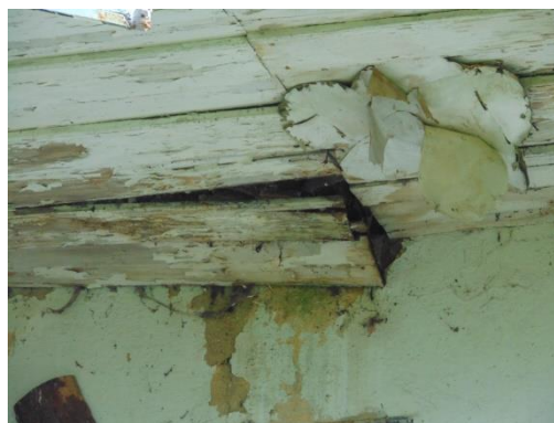
Obr. 44 Detail propadlého stropu nad verandou
