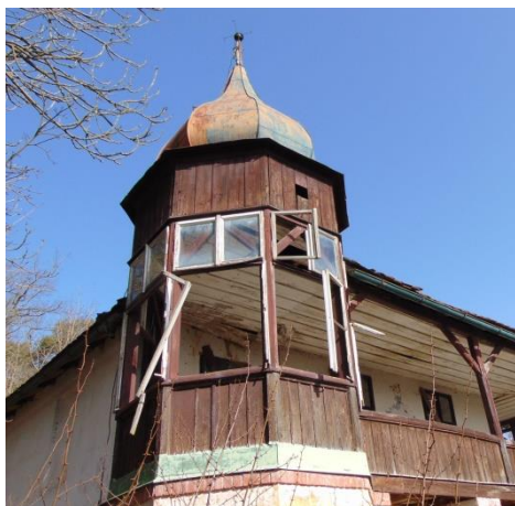
Obr. 51 Poškození okenní rámy věžičky
