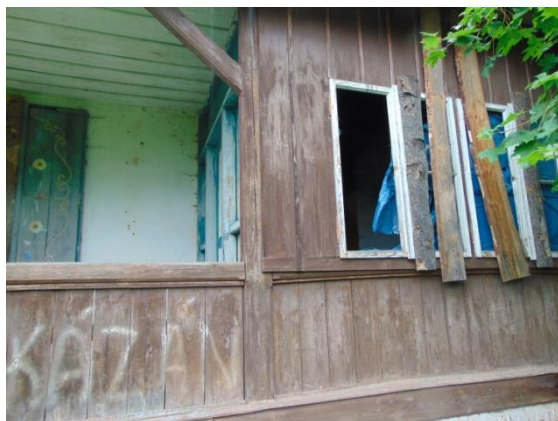
Obr. 55 Vysklené okenní rámy
