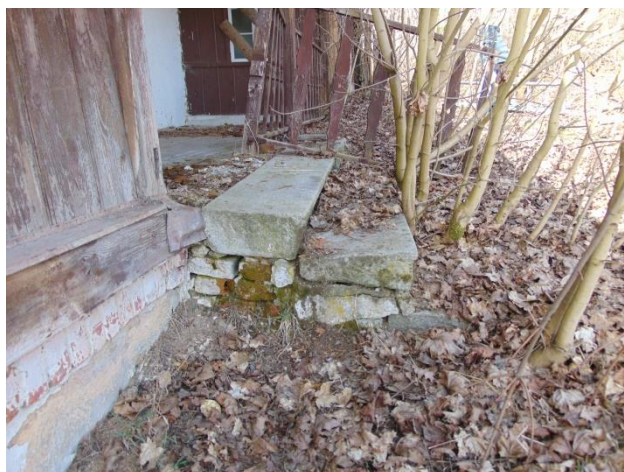
Obr. 54 Zarostlé schodiště v terénu
