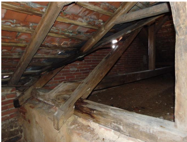
Obr. 91 Degradované úžlabí krovu
