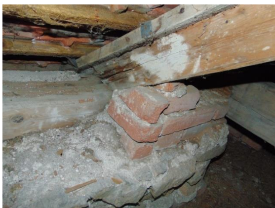
Obr. 49 Narušené zhlaví krokvi
