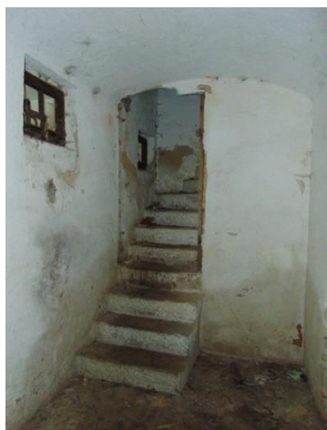
Obr. 53 Vztlínající vlhkost okolo schodiště
