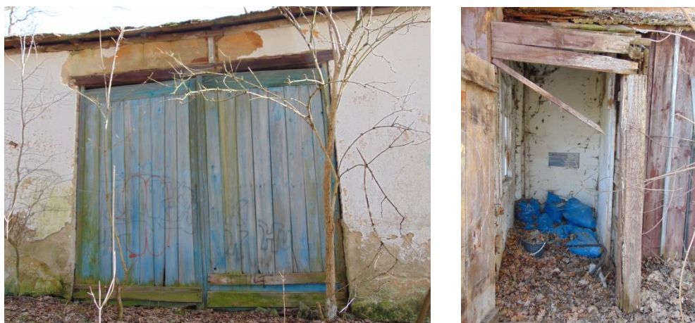
Obr. 46 Poškozené nadpraží stodoly a dřevěného přístavku
