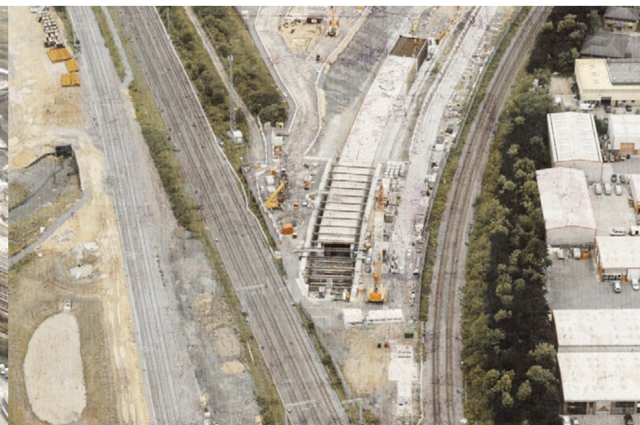
Náhled na konstrukci betonového tunelu. Protlačovaná konstrukce pod East Cost Main Line ve Velké Británii
