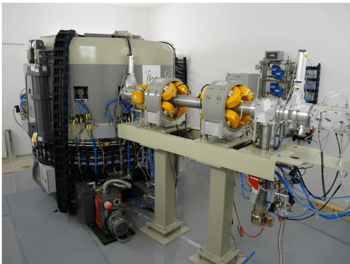
Obrázek 4.2: IBA Cyclone 18/9 v betonové kobce v ÚJV Řež.
