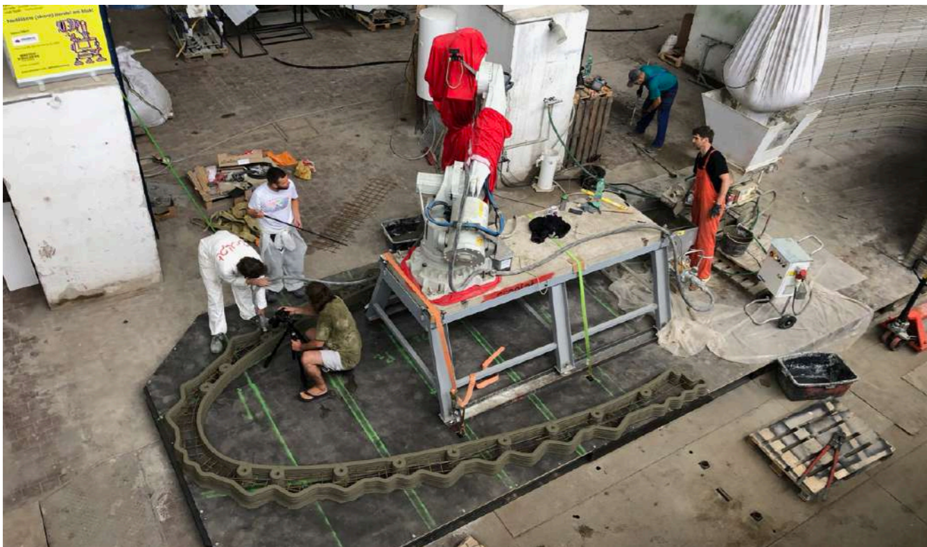
Obr. 10 Robotické rameno ABB (Máša) je osadené na vyvýšenej platforme. Týmto spôsobom bolo docielené zväčšenie rozsahu ramena.
