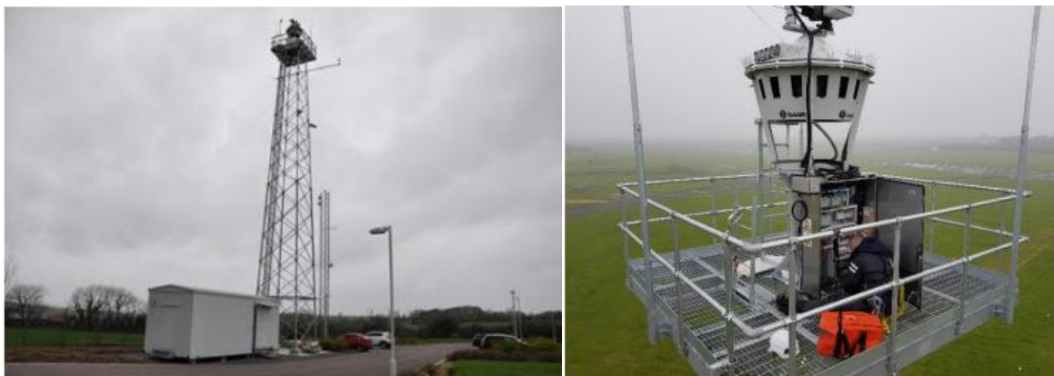
Obrázek 8 Věž r-TWR (vlevo). Servisní balkón (vpravo). Zdroj: [43]
