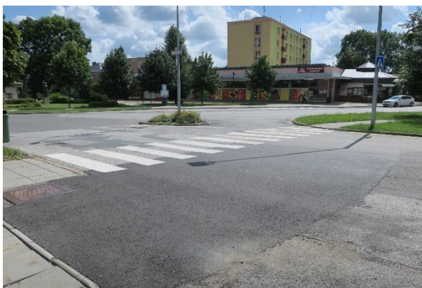
Obrázek 5.20: Pohled na západně situovaný přechod pro chodce v těsné blízkosti stykové křižovatky, kde na snímku je zobrazena absence prvků OOSPO a neadekvátní délka přechodu.
