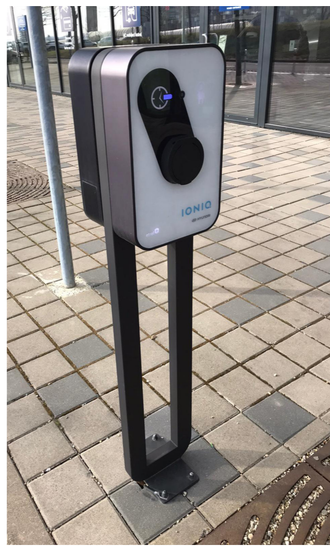
Ionig AC nabíječka - Wallbox zavěšený na konstrukci
