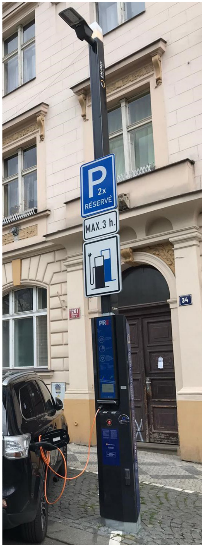
Pre AC nabíječka integrovaná do pouličního osvětlení 22
