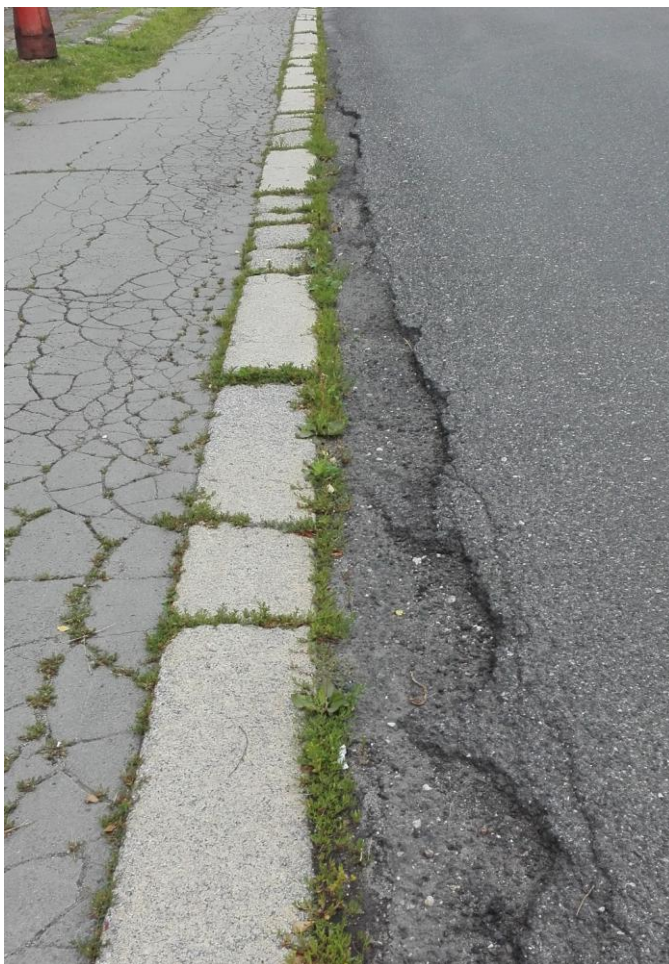
Obrázek 6 – Praskliny na chodníku a výtluky vozovky v ulici Nádražní
