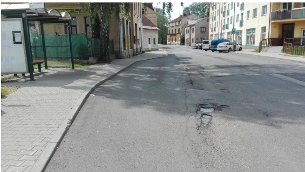
Obrázek 7 – Výtluky a praskliny u autobusové zastávky Rychnov, náměstí
