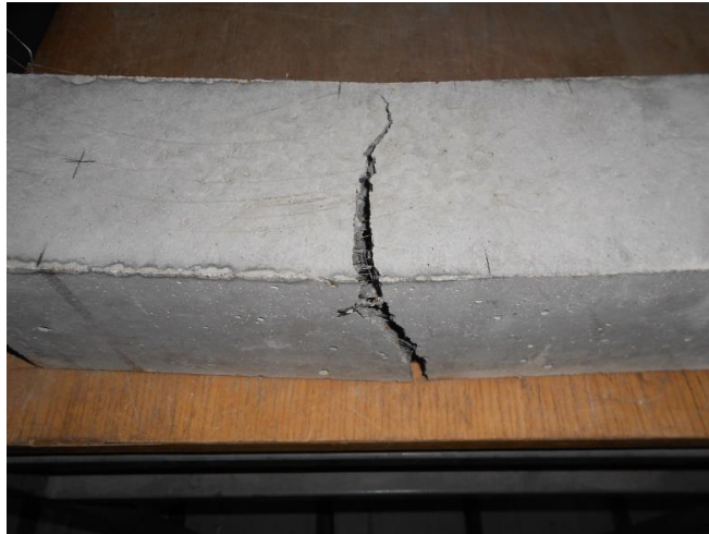
Obr. 28 Pohled na trhlinu v trámku po ukončení měření při průhybu 40mm rozevření se vrátilo o 40% zpět.
