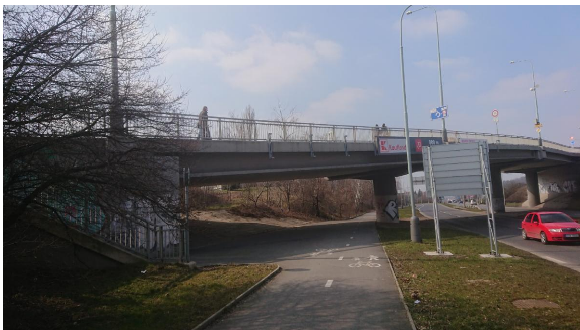
Fotografie 10: Pohled na most přes Chlumeckou ulici. Volná výška pod mostem v prvním mostním poli u opěry činí 3,1 m, tramvajovou trať navrhovanou ve Variantě B Úseku 2 by tak bylo nutné vést v zářezu. Pohled proti směru staničení.
