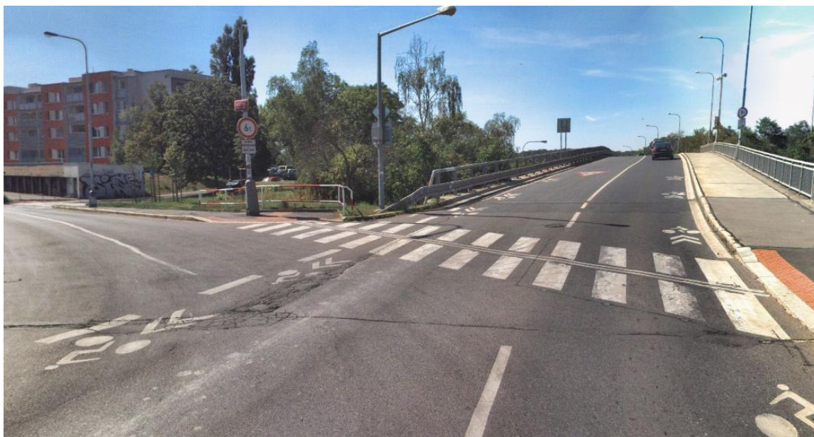
Obrázek 4: Detail poškozené krycí vrstvy konstrukce vozovky v místě jihovýchodní opěry mostu přes ul. Chlumecká [25]
