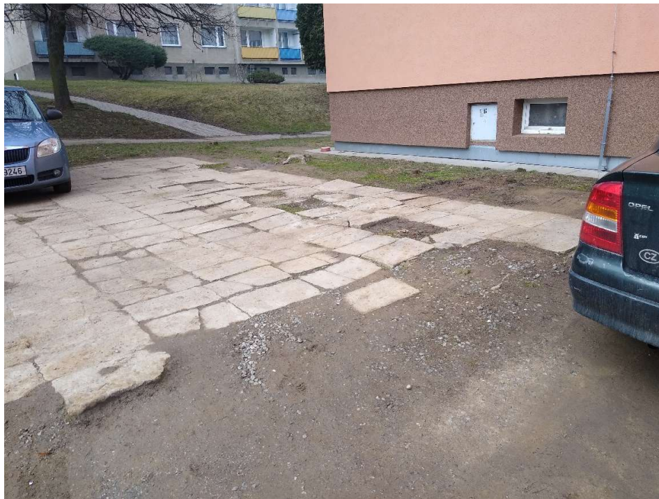
Obr. 10 - Detail poškození parkoviště, zdroj vlastní
