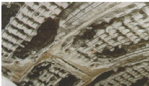
Obrázek 5.9: Poškozené ostění Eurotunelu v důsledku požáru
