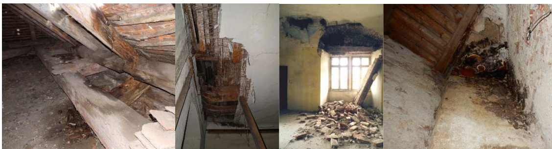
Obr. 8: Dřevomorka domácí v krovu prelatury způsobila poškození nosných prvků krovu, stropu a zborcení okenního nadpraží, klášter Chotěšov (foto Archiv ATELIER SOUKUP OPL ŠVEHLA s. r. o., Plzeň)
