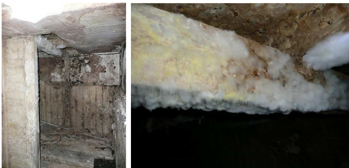
Obr. 7: Porost mycelia dřevomorky domácí na dřevěném obkladu sklepního prostoru a betonovém stropu, objekt č. 56, Plzeň (foto Archiv ATELIER SOUKUP OPL ŠVEHLA s. r. o., Plzeň)
