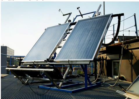
Obr. 5.6 Dva zasklené neselektivní FVT kolektory zapojené v sérii
