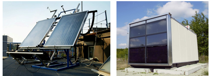
Obr. 4 Měřená aplikace na střeše Fakulty strojní (vlevo), měření energeticky aktivního fasádní modulu s integrovaným FVT kolektorem na UCEEB (vpravo)
