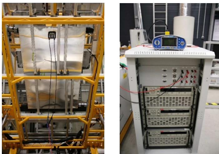
Obr. 3.16 Elektrické zapojení FVT kolektor na zadní straně (vlevo) a elektrická zátěž ZSAC a měřicí zařízení Metrel MI 3108 (vpravo)
