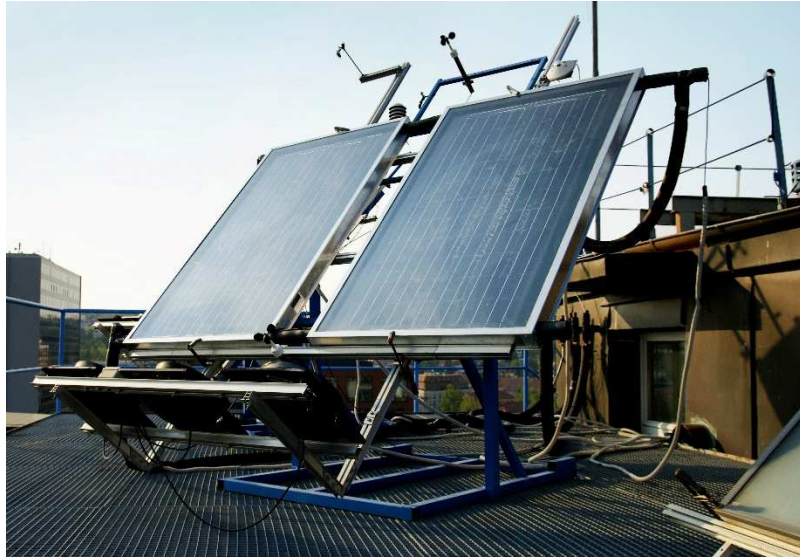
Obr. 5.8 Dva zasklené neselektivní FVT kolektory zapojené v sérii
