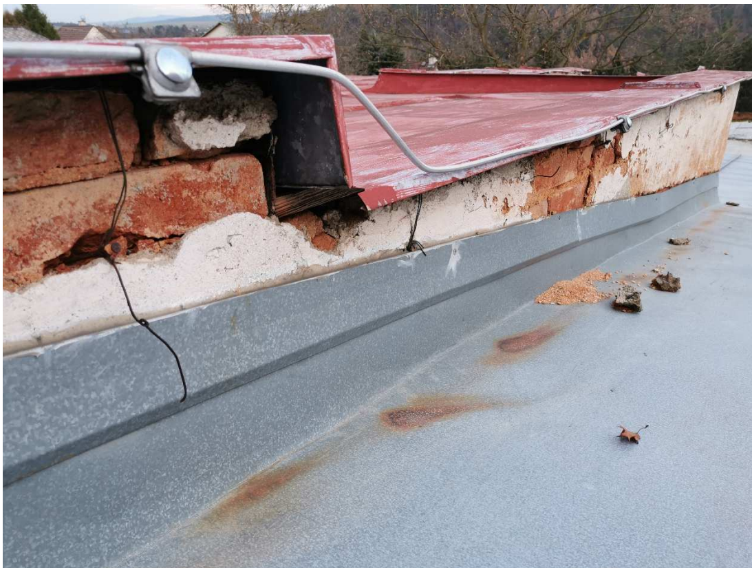
Obrázek 46, Netěsné oplechování atiky
