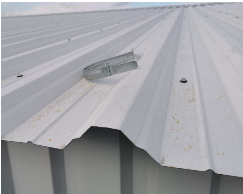
Obrázek 8, Rez na trapézové krytině
