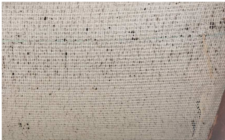
Obrázek 10, Detail degradované pojistná hydroizolace
