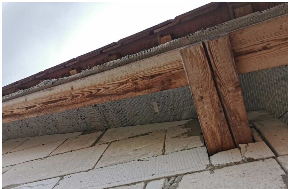
Obrázek 9, Pohled na degdovanou pojistnou hydroizolaci
