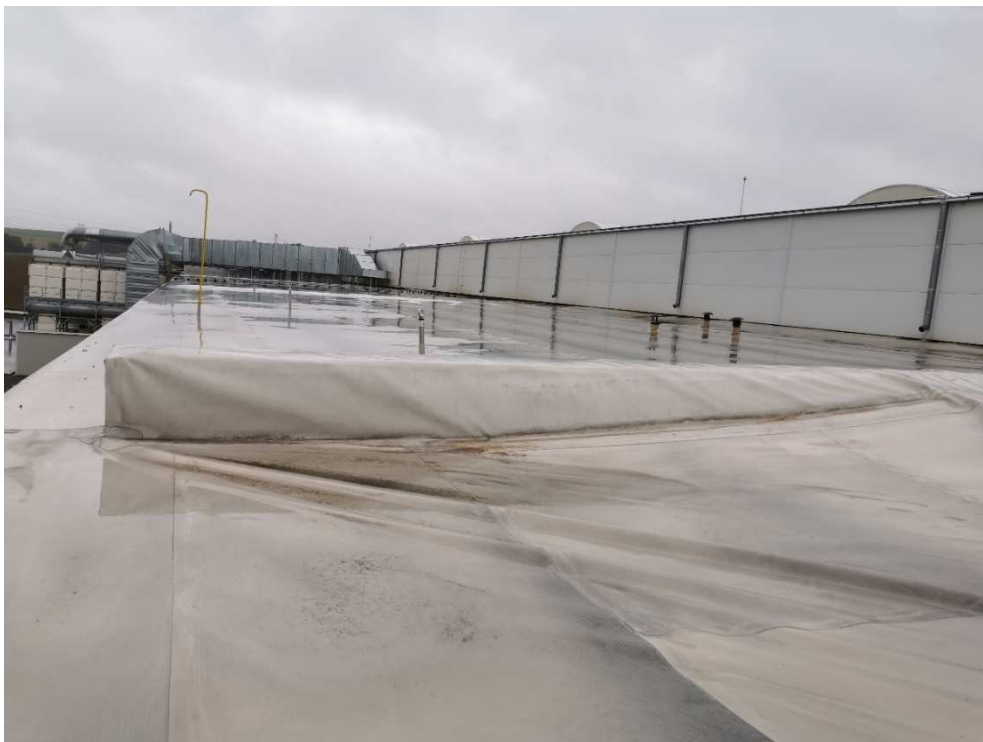
Obrázek 16, Pohled na vyšponovanou střešní fólii
