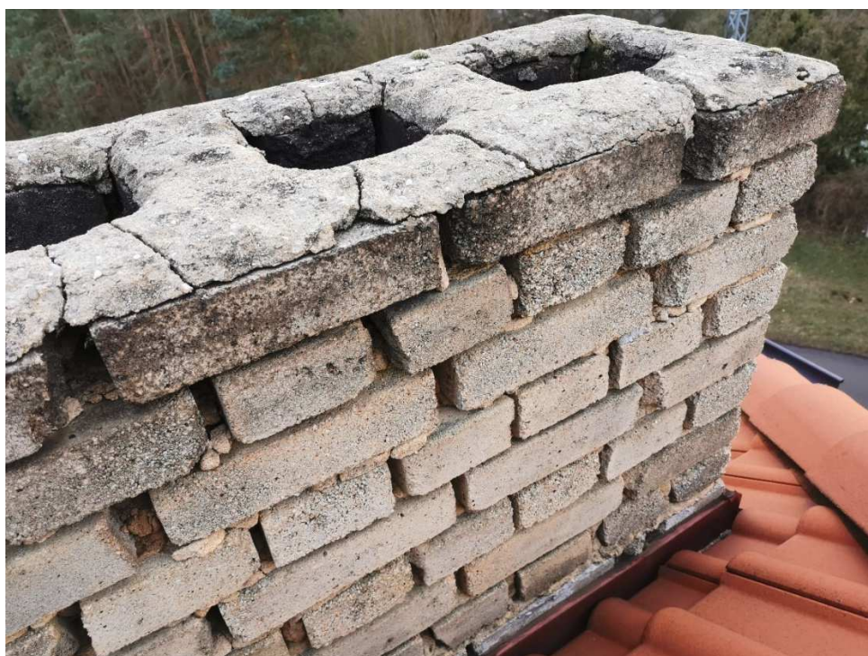
Obrázek 31, Komín v havarijním stavu
