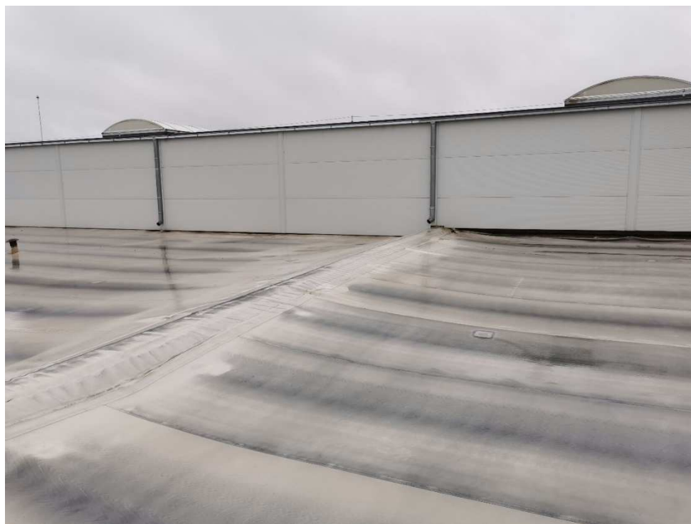
Obrázek 17, Pohled na vyšponovanou střešní fólii přes vnitřní atiku
