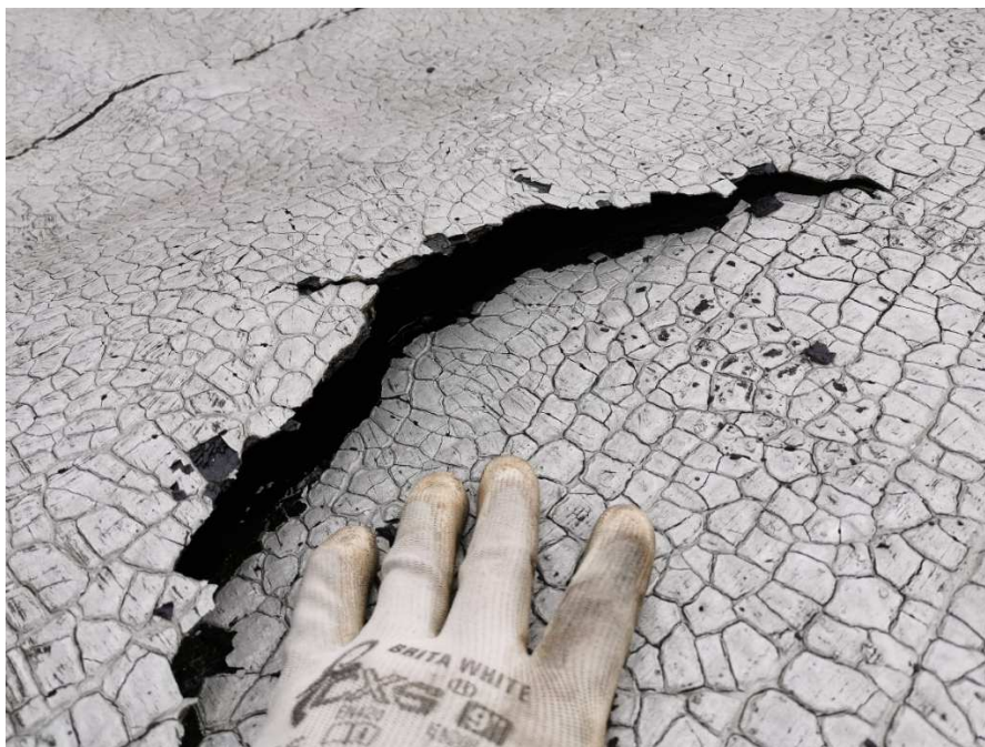
Obrázek 11, Prošláplý puchýř v asfaltovém pásu
