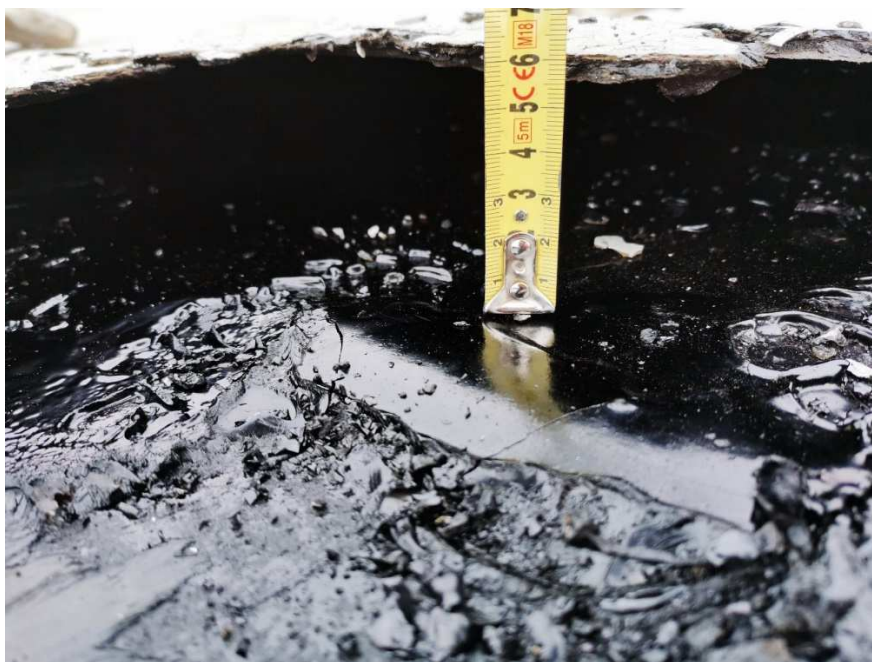
Obrázek 13, Detail porušeného asfaltového pásu
