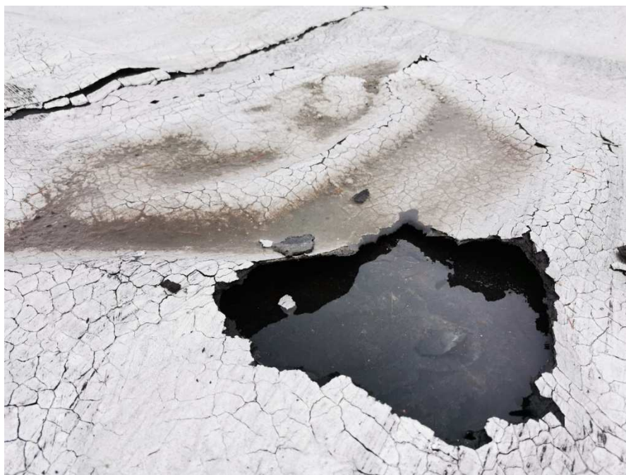
Obrázek 12, Porušený puchýř v asfaltovém pásu a v něm viditelná voda
