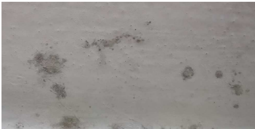
Obrázek 22, Plíseň na podhledu
