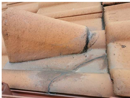
Obrázek 29, Prasklá větrací taška
