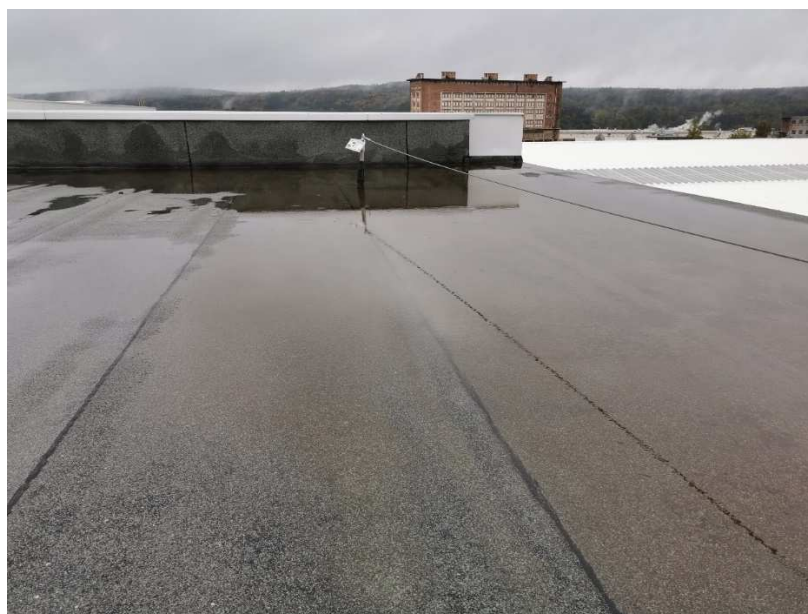
Obrázek 15, Stojící voda na ploché střeše, pohled k okapní hraně
