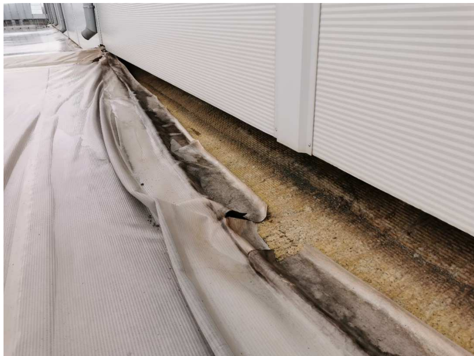
Obrázek 18, Vytržená střešní fólie, přímé zatékání do tepelné izolace
