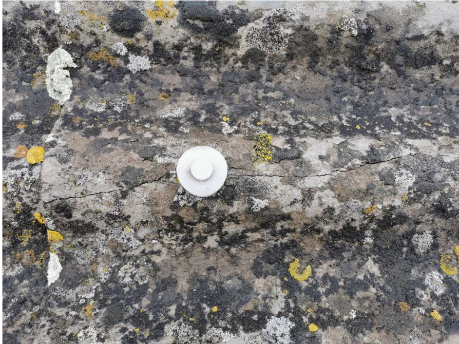
Obrázek 6, Podélná prasklina v eternitové desce
