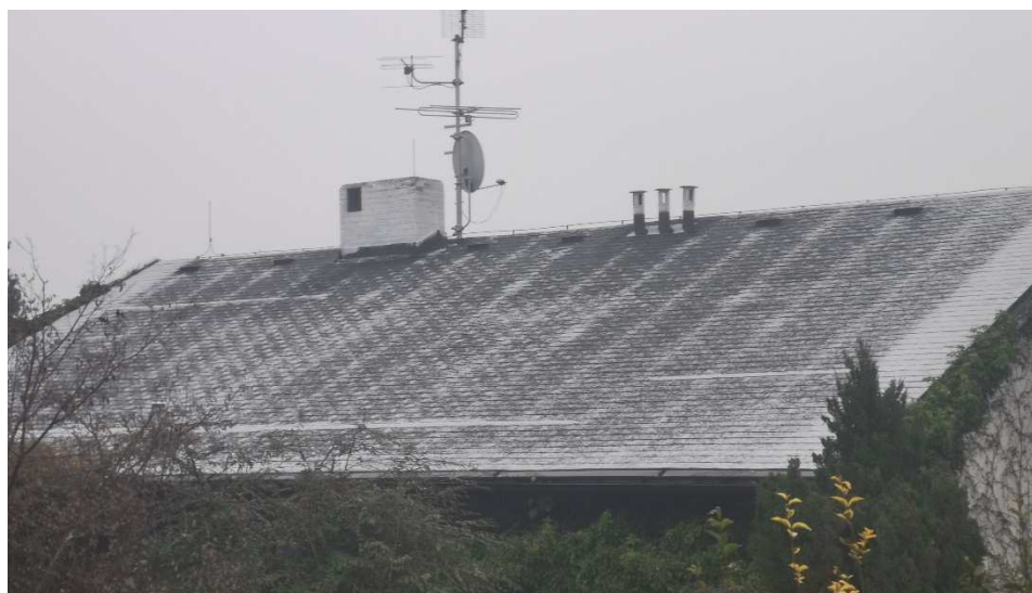
Obrázek 21, Pohled na nefunkční skladbu střešní konstrukce
