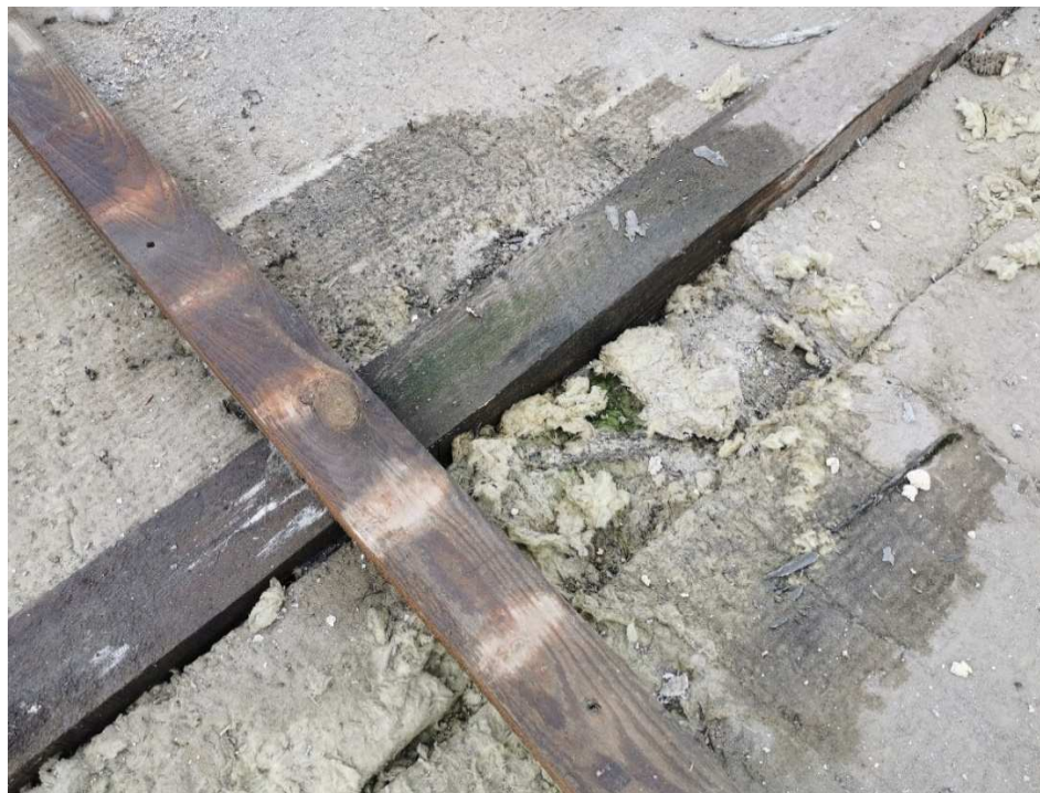
Obrázek 7, Navlhlá tepelná izolace a krov
