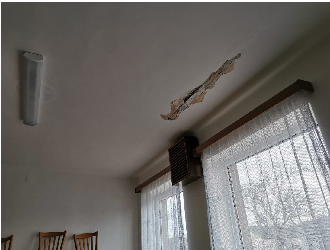
Obrázek 47, Zatékání do přednáškové místnosti
