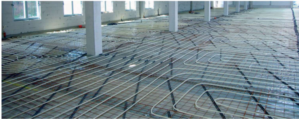
Obr. 5. – Teplovodní podlahové vytápění v hale [10]
