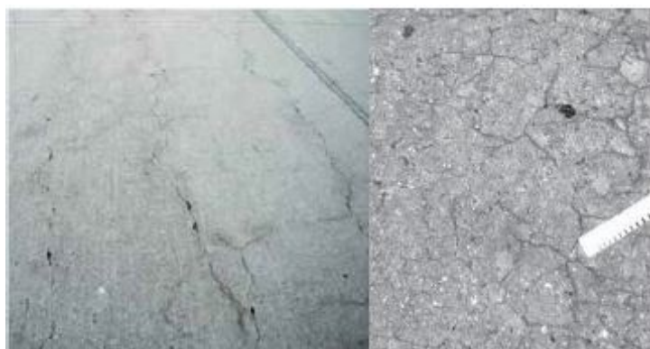
Obrázek 2.6: Trhliny v cementobetonových krytech vozovek (vlevo podélná trhlina, vpravo mapové trhliny) [3]
